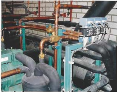
■ Valves d'expansion et échangeur de chaleur
